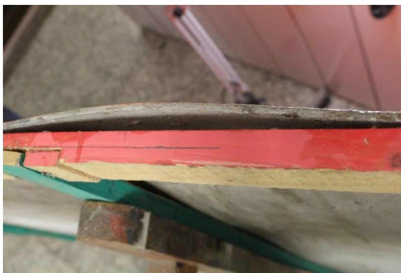
Figura 65: Detalhe da deformação vista de topo, onde se pode constatar o remendo da grade referido anteriormente.
