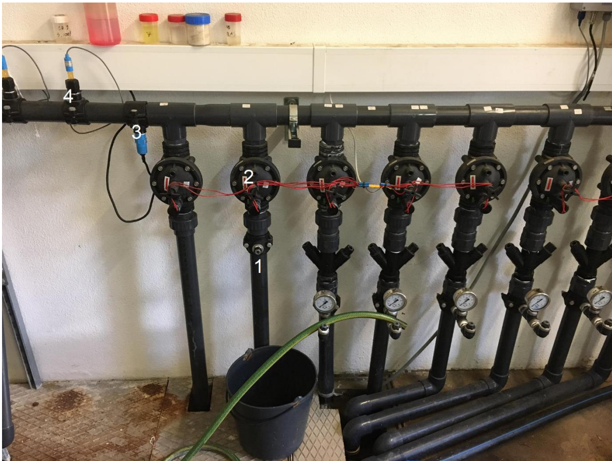
Figura 8: Tubagens do sistema da vinha. 1- Válvula de entrada de ar. 2- Electroválvula. 3- Medidor de condutividade eléctrica. 4- Medidor de pH.
