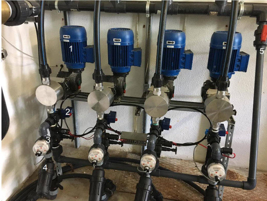
Figura 4: 1- Bomba doseadora de pistão (D054-220 L/L T); 2- Sistema de retrolavagem Aquative Plus; 3- contador volumétrico; 4- Filtro de malha (TVL1"TLH-L-120 mesh); 5- Válvula manual.
