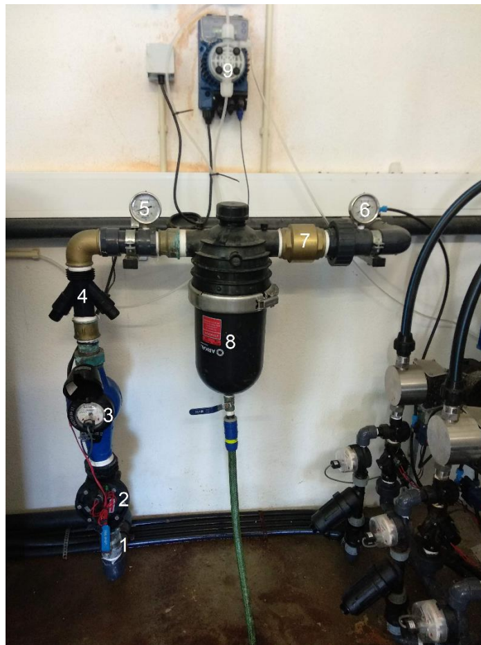
Figura 5: 1- Válvula de segurança; 2- Electroválvula; 3- Contador volumétrico principal do sistema; 4- Regulador de pressão 2000 11/2" 4 bar; 5 e 6- Manómetros de 10 bar; 7- Válvula anti retorno; 8- Filtro de discos AK DUAL RM 2"-120 mesh; 9. Bomba electromagnética doseadora de ácido.
