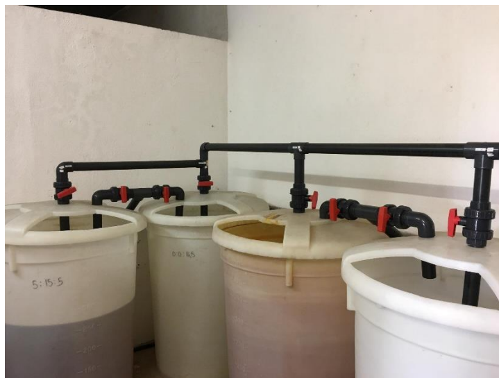
Figura 3: Depósitos tronco-cónicos com 500 L de capacidade e circuito de ar comprimido que actua como agitador
