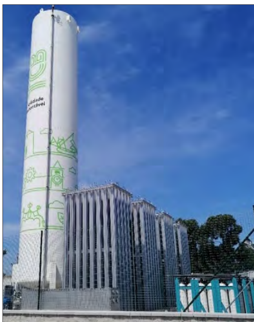
Figura 29 – Depósito de gás dos TCB
