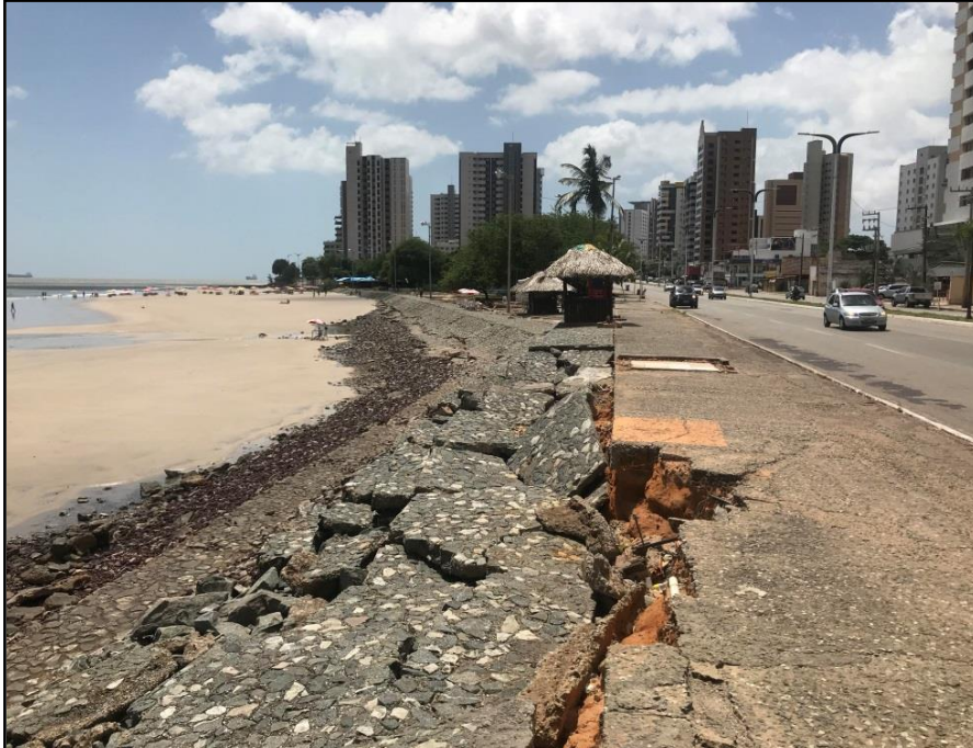
Figura 94 - Erosão existente no calçadão da Ponta D'Areia
