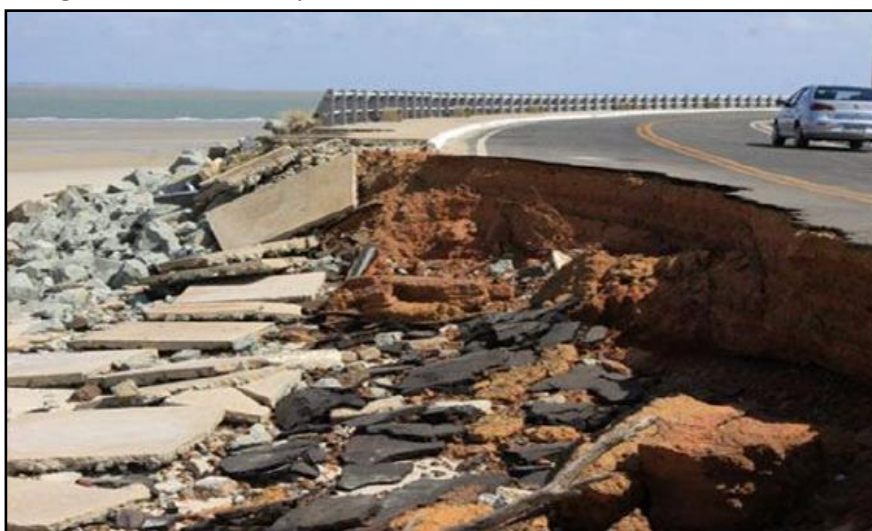
Figura 44 - Erosão na ponta da área da Península na década de 1990
