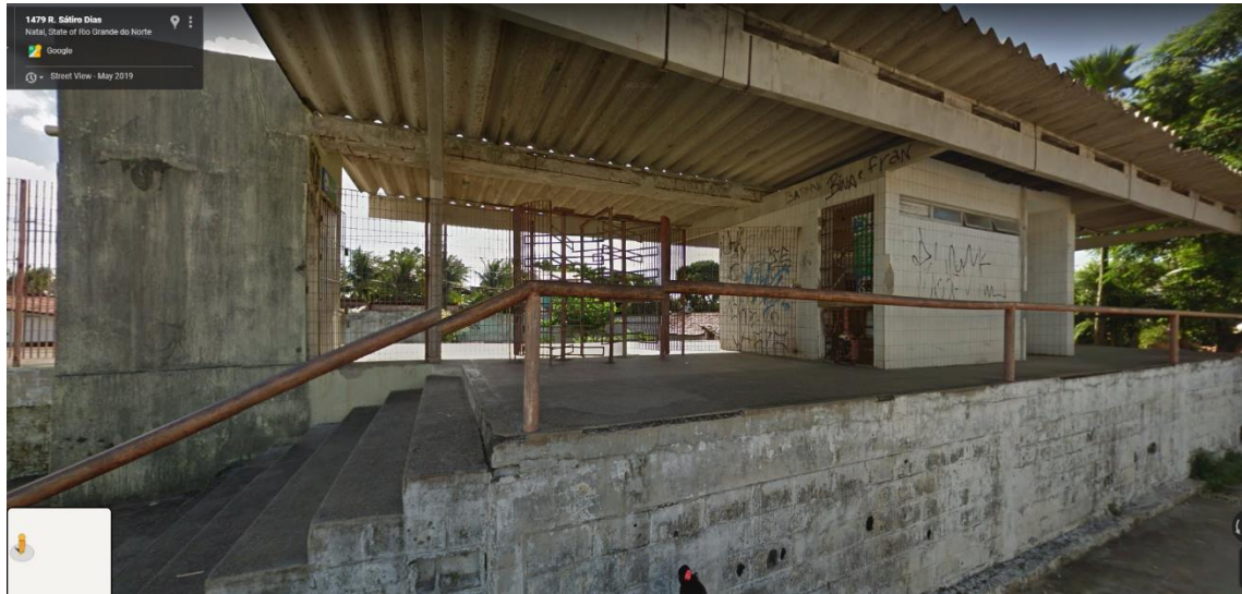
Figura 1. Estação de Trem – Estação Alecrim II - na Cidade de Natal - RN, Brasil. Fonte: Google Maps, acesso: 14.03.2022 em: < https://bityli.com/dulmsH >.
