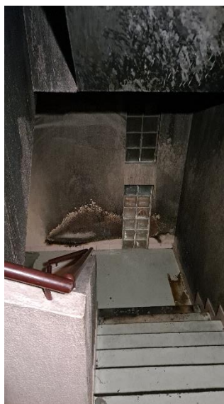
Figura |32 Atos de vandalismo em espaços comuns, Bairro do Oriente, 2023 (autor)
