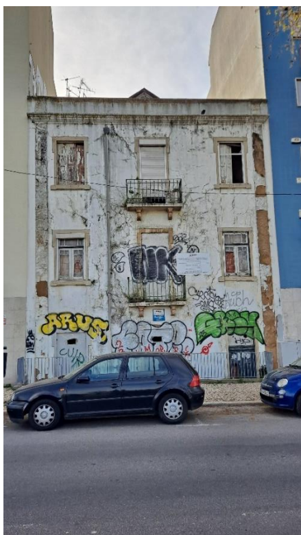
Figura |45 Edifício habitacional devoluto, Lisboa, 2024 (autor)
