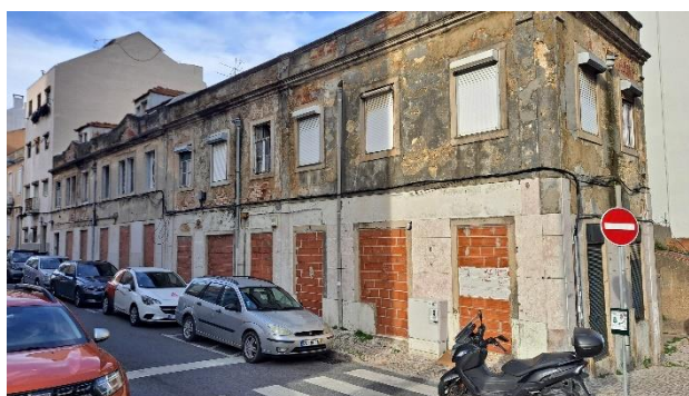
Figura |46 Edifício habitacional devoluto, Lisboa, 2024 (autor)
