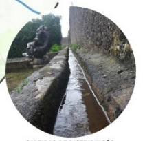
CALEIRAS DE DISTRIBUIÇÃO
