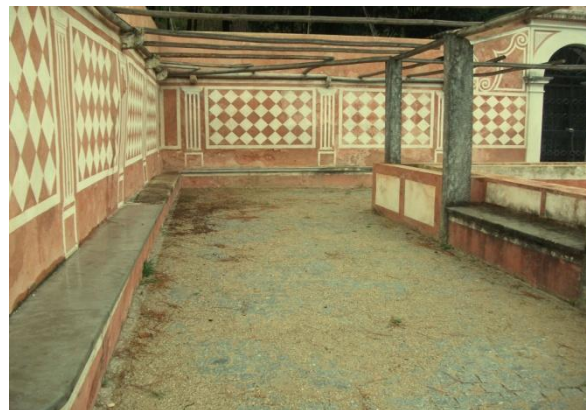
FIG.45 – Actual estado de conservação dos muros (autora)
