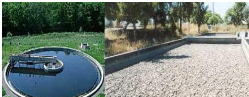
Figura 4 - Tanque de decantação e leito de secagem de lamas.
