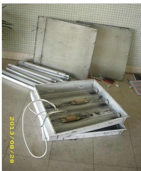
Figura 104 – Luminárias removidas da zona envidraçada do telheiro
