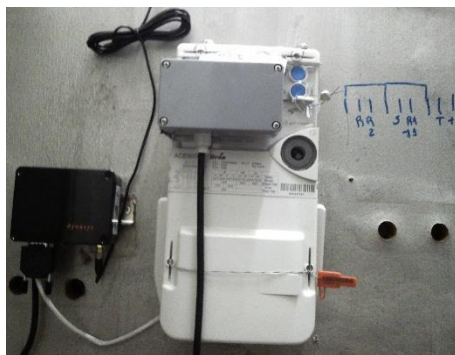
Figura 26 – Máscara de leitura dos sinais óticos do contador de energia
