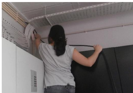
Figura 52 – Instalação dos novos circuitos elétricos para alimentação das cargas da copa do piso 4
