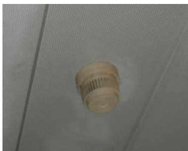
Figura 120 – Exemplo dos detetores iónicos de fumo instalados no LNEG
