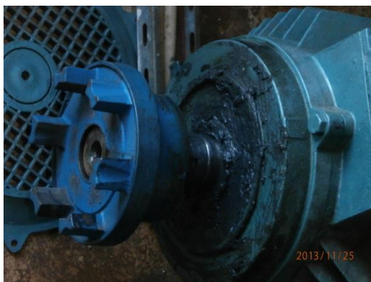
Figura 93 – Limpeza e lubrificação do grupo turbina/impulsor
