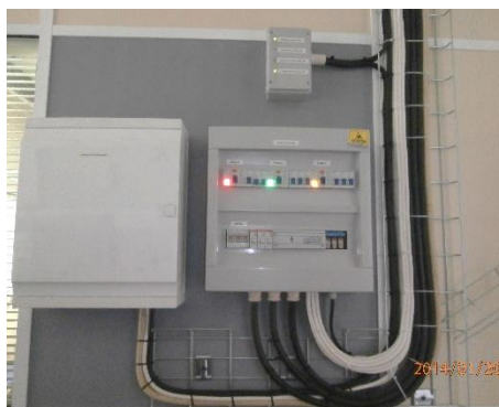
Figura 58 – Quadros elétricos de apoio à sala dos servidores
