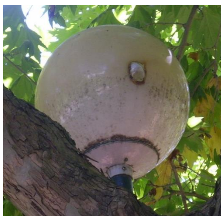
Figura 113 – Exemplo de um globo de proteção escurecido e danificado
