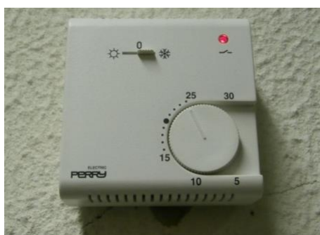
Figura 84 – Termostato instalado para regulação da temperatura do ar insuflado pela UTA 3
