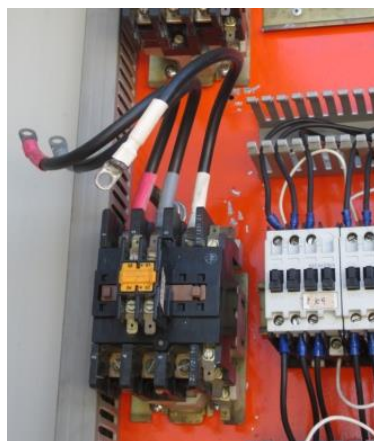
Figura 73 – Contatores instalados no circuito de alimentação dos ventiladores
