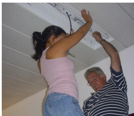
Figura 97 – Instalação das luminárias com balastros eletrónicos na sala do secretariado da direção
