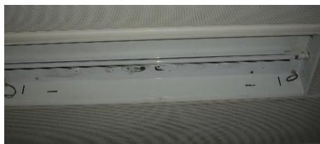
Figura 99 – Luminária com lâmpada Eco-Tubo®
