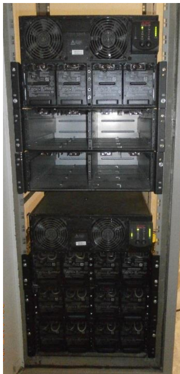
Figura 56 – UPSs instaladas no piso 0
