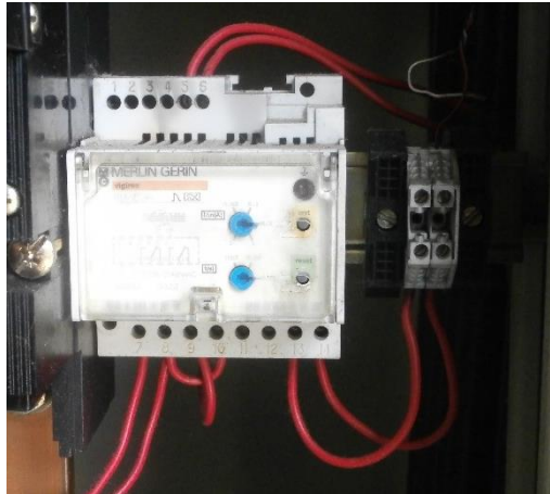
Figura 27 – Vigiador de corrente para deteção de defeitos à terra
