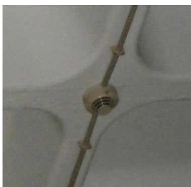
Figura 121 – Exemplo dos detetores termovelocimétricos instalados no LNEG
