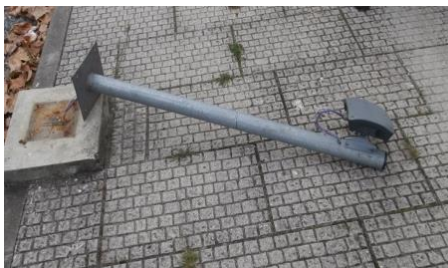
Figura 129 – Remoção do leitor ótico de cartões de identificação de abertura da cancela
