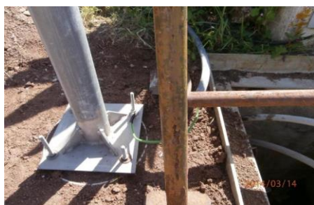
Figura 130 – Ligação à terra do portão Sul através do poste da câmara de vigilância
