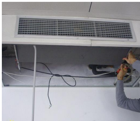
Figura 95 – Ligação do tubo de água ao ventiloconvetor
