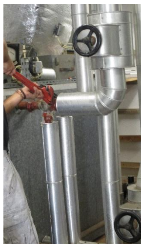
Figura 82 – Alteração do sistema de distribuição de água climatizada para as UTAs
