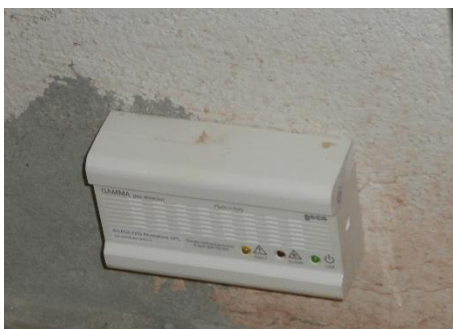
Figura 77 – Detetor de gás propano instalado junto à caldeira
