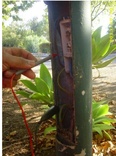
Figura 114 – Medição da resistência do isolamento da coluna de sustentação de uma das luminárias do circuito Norte
