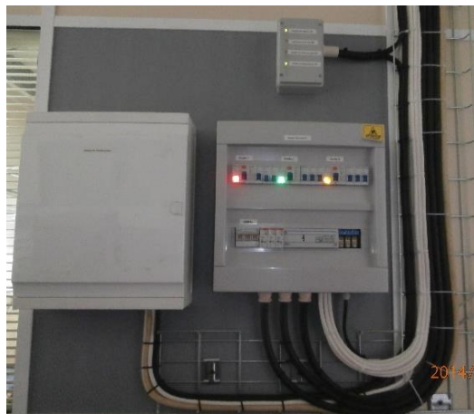
Figura 29 – Quadros elétricos instalados no núcleo de informática
