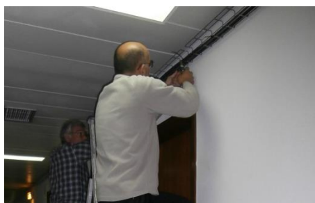
Figura 57 – Colocação dos cabos de transmissão de energia para alimentação dos servidores a partir das UPSs instaladas no piso 0
