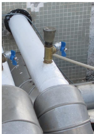
Figura 89 – Sistema de purga com torneira manual instalado nas tubagens de água
