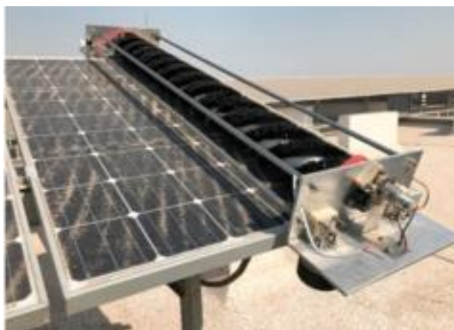
Figura 25- Sistemas Motorizados De Limpeza De Painéis Solares Com Máquinas Ligeira [81].
