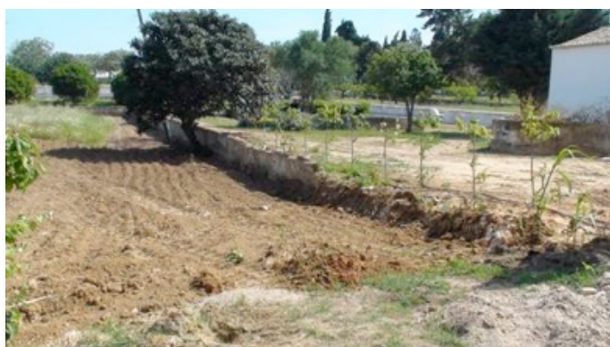
Figura 90 - Muretes destruídos (Fonte: José Brito)
