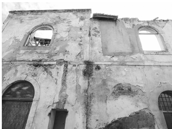
136. Fachada em ruína da fábrica em Alfange, 2020
