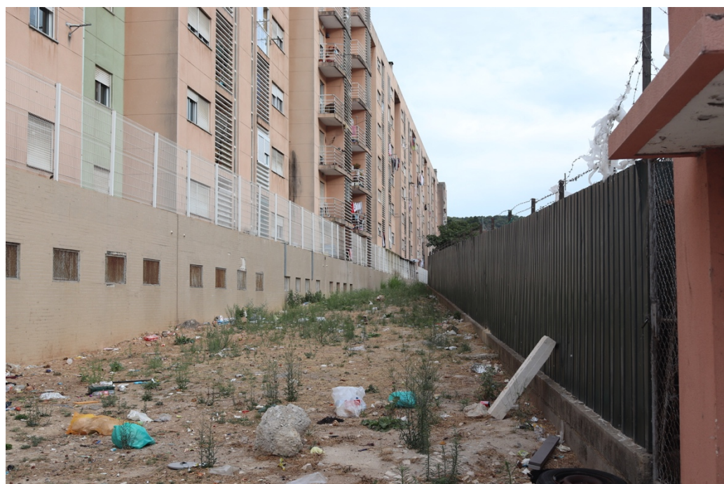
Figura 87. Fotografia da degradação do Bairro da Horta Navia, 2020.
