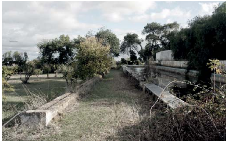
90 | Tanque rectangular junto ao muro de contenção dos socalcos
