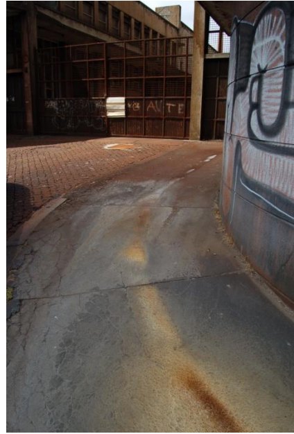
Fig. 98 - Edifício Oliva na Actualidade. Alguns passeios, estradas e paredes em volta da Oliva têm marcas de ferrugem, causadas pela ausência de filtros nas chaminés, após a Oliva ter sido vendida à ITT.
