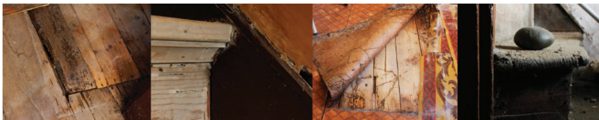
Figura 04.37 - Principais anomalias nos pavimentos e degraus de madeira, imagens da autora
