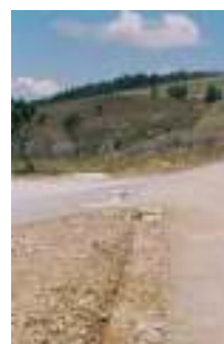
FIGURA B-3 – Valeta de drenagem no Parque Eólico de Safrá (SIC PTCO0060 – “Serra da Lousã”).
