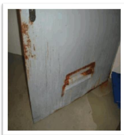
Ilustração 8 – Porta com evidência clara de oxidação (fotografia original)
