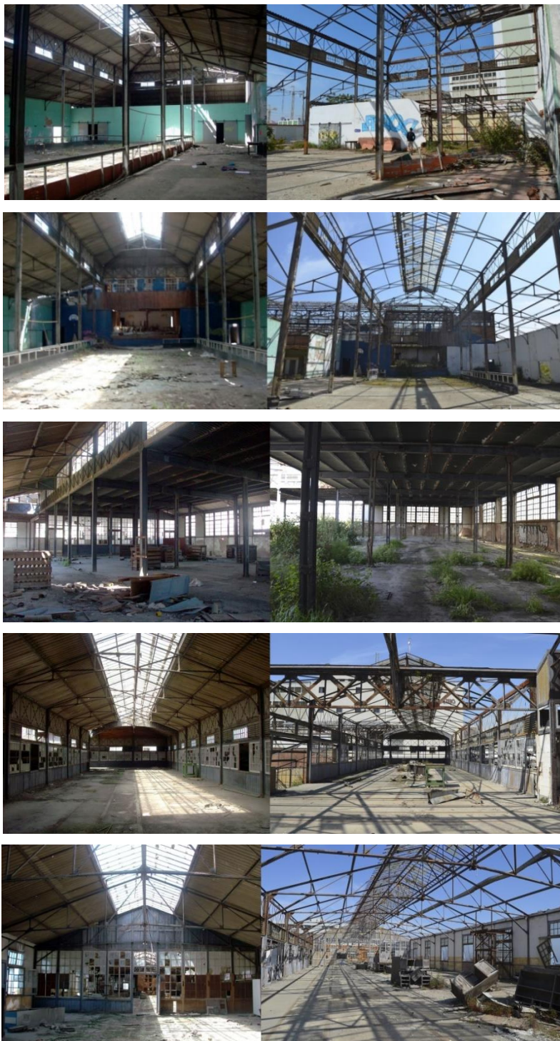
Figura 59 – Processo de Deterioração do edifício “A Tabaqueira”. À esquerda: Autor: Telmo Sequeira (2009). À direita: 2017
