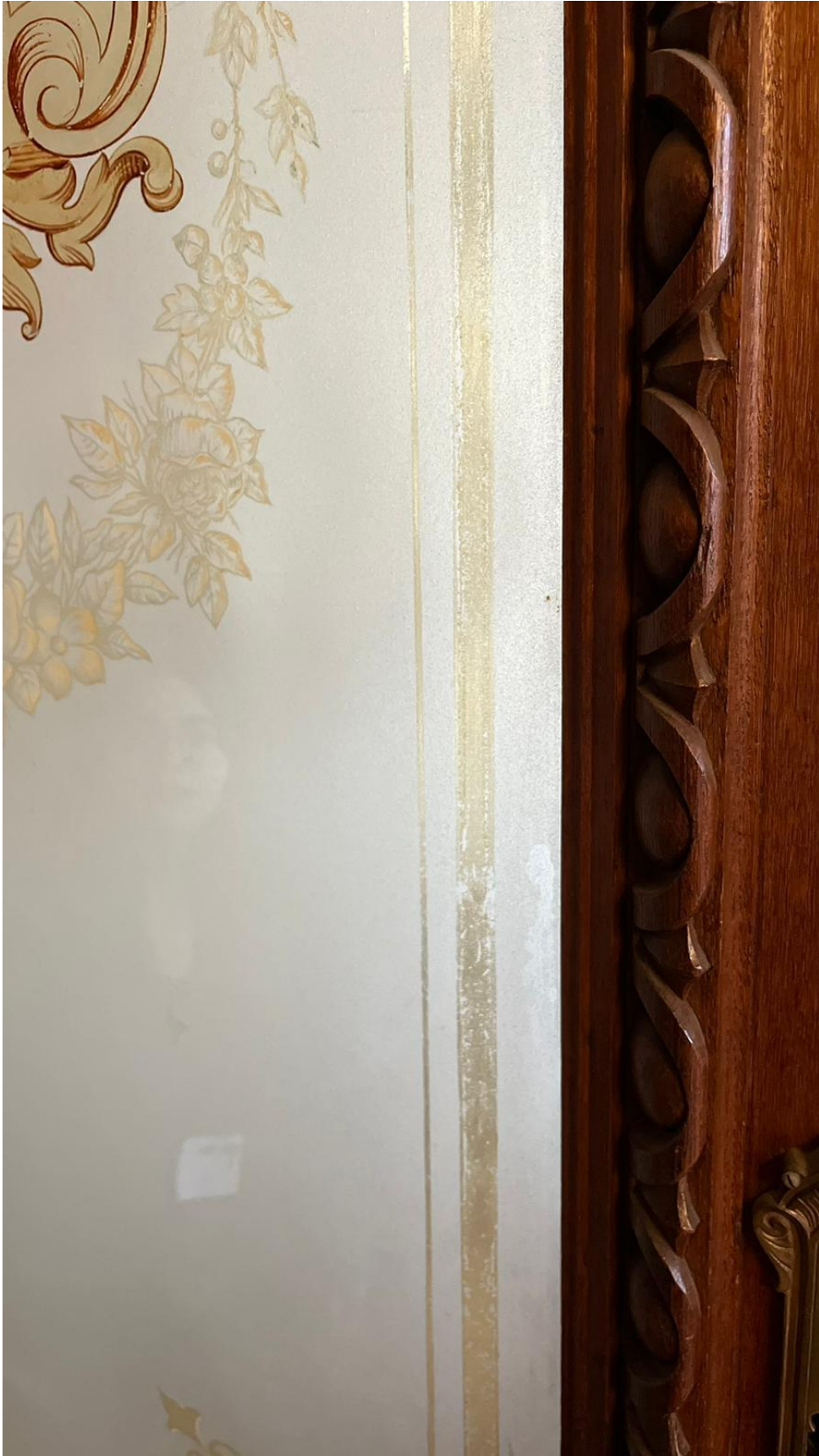
Vidraça 69847/b com marcas de desgaste na pintura.
