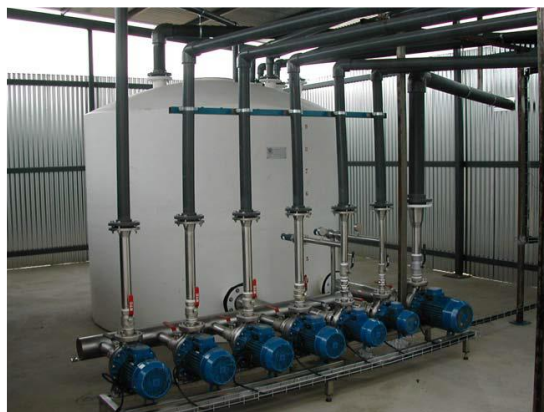
Figura 15. Depósito pulmão isotérmico de 5000 litros com bombas de circulação. AGROVIN
