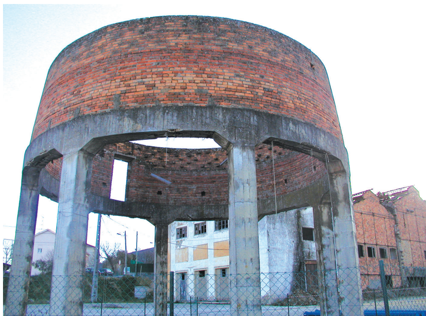
FIGURA 2 Torre de refrigeração.
