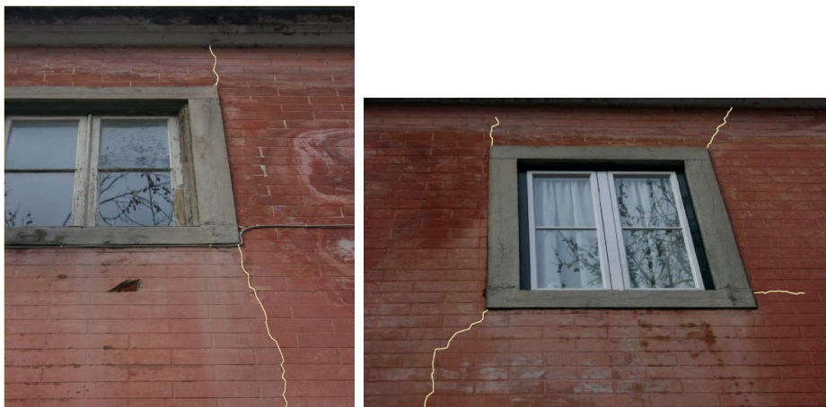
Figura 79 | Desenvolvimento de fissuras nos cantos dos vãos
