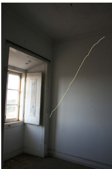
Figura 75 | Fissuração nas paredes interiores
