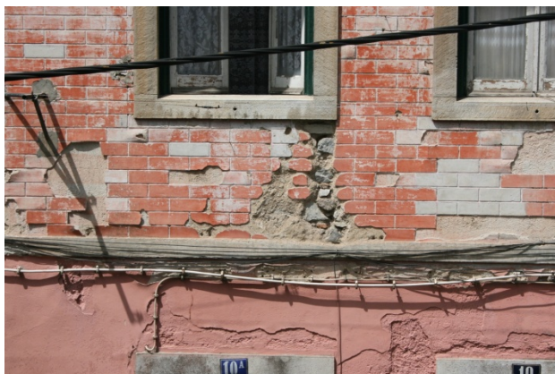
Figura 30 | Destacamento e descolorimento do revestimento
