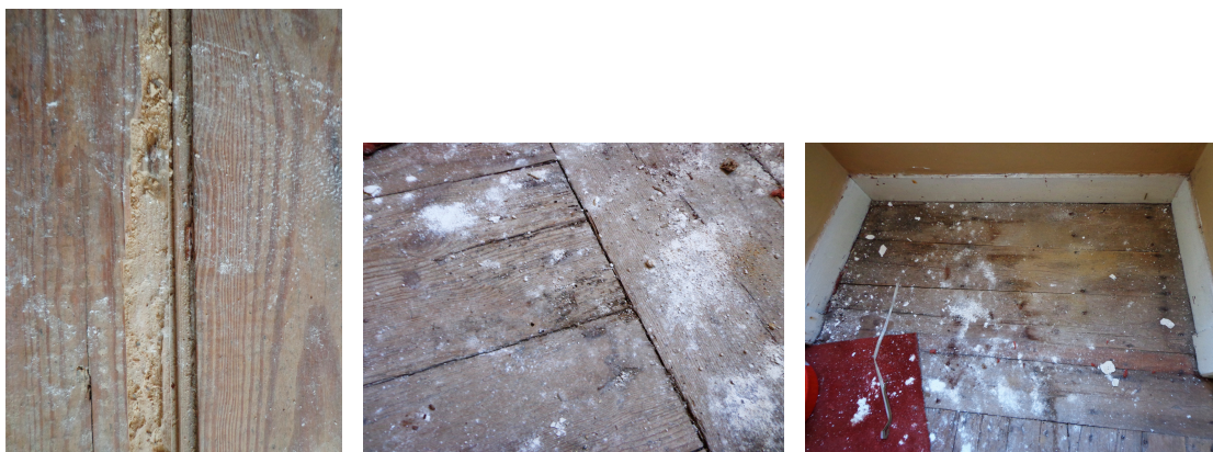
Figura 92 | Soalho de madeira infestado com insectos xilófagos e fungos
