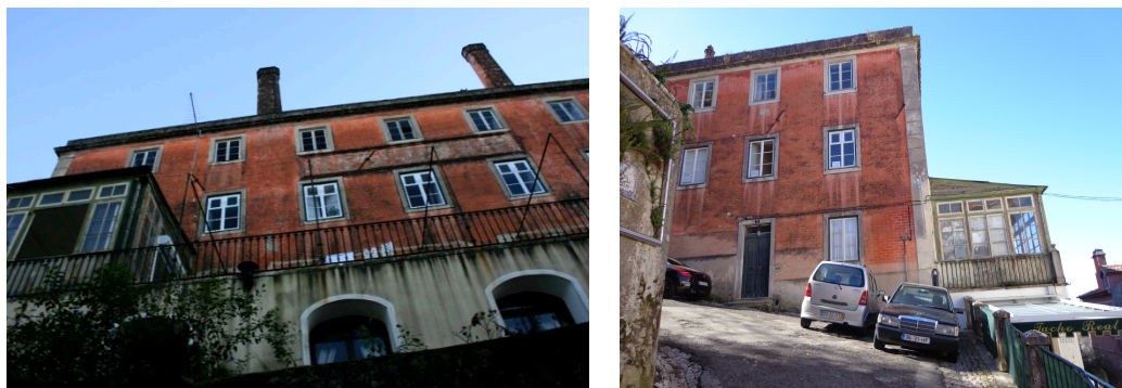
Figura 74 | Degradação generalizada dos revestimentos exteriores
