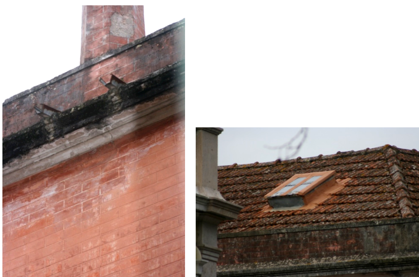
Figura 81 | Problemas de infiltrações na cobertura
