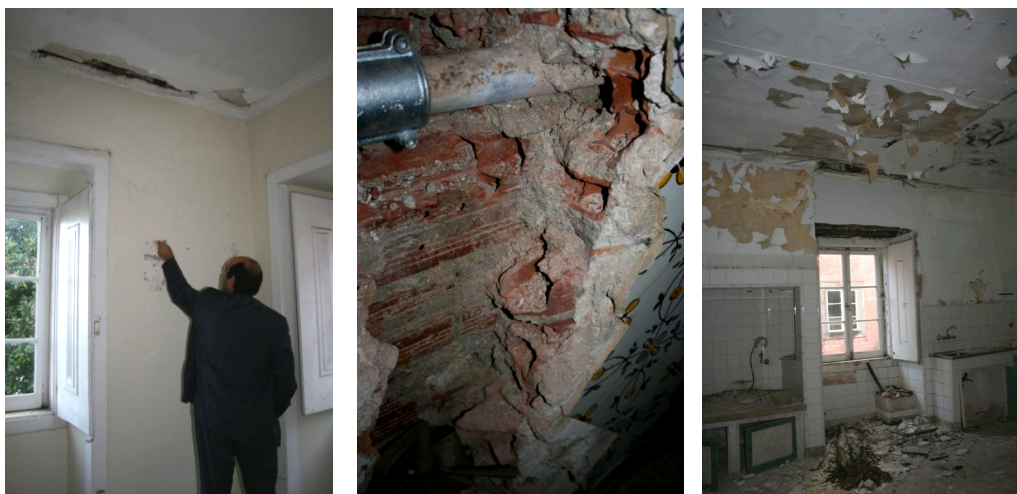
Figura 49| Processo de inspecção e diagnóstico - Registo fotográfico de várias anomalias
