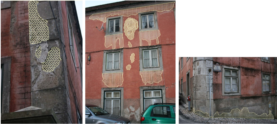
Figura 83 | Manchas e destacamento dos revestimentos exteriores
