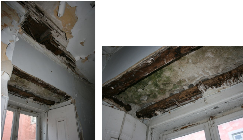
Figura 80 | Apodrecimento dos lintéis de madeira
