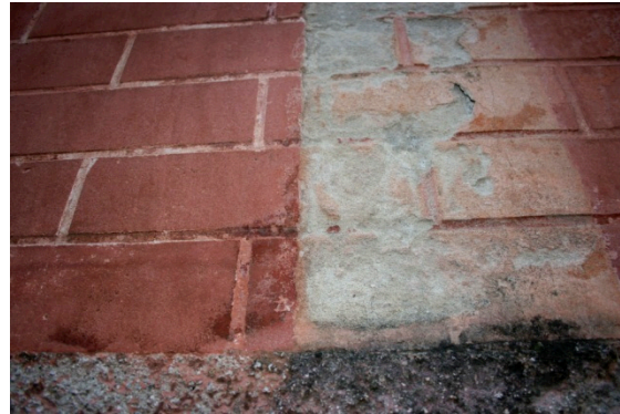
Figura 45 | Degradação do fingido junto aos tubos de queda
