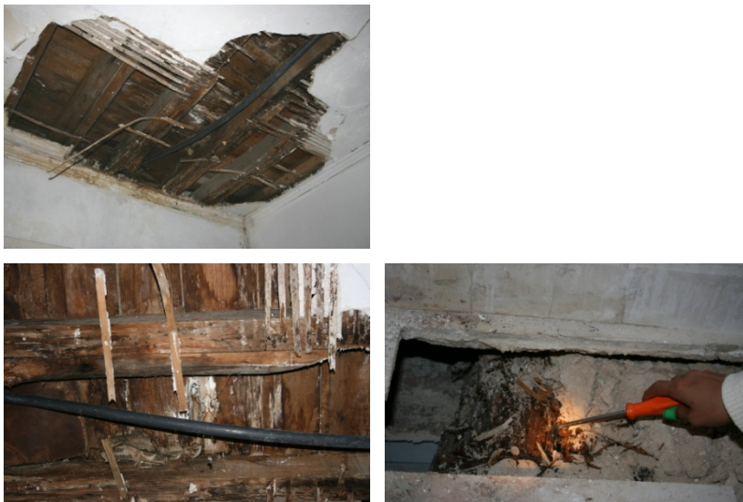
Figura 91| Podridão nos elementos de madeira das lajes de pavimento e tectos
