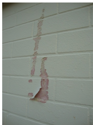
Figura 32 | Pormenor do destacamento da pintura recente
