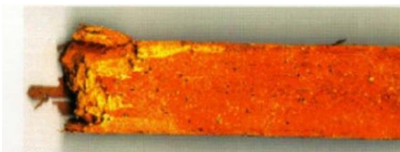
FIGURA 2.3.2.1.7: Aspeto da madeira atacada por inseto Coleóptero
