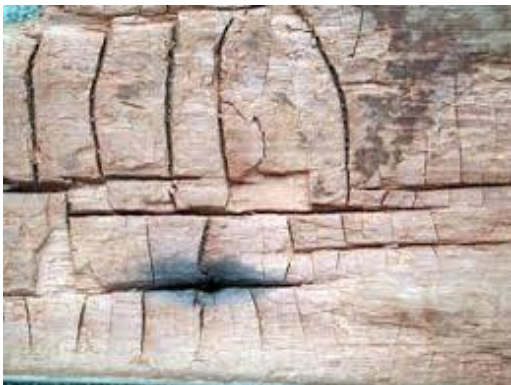
FIGURA 2.3.2.1.3: as regiões atacadas por fungos de podridão parda apresentam essa camada com fendas quebradiças cúbicas que se desmancham em pequenos fragmentos e até pó com muita facilidade mesmo ao toque manual.
