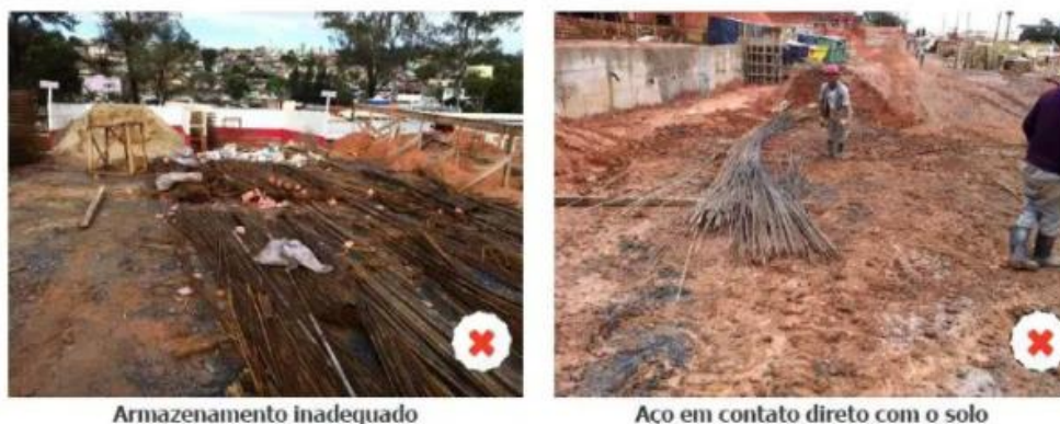
Figura 22 - Armazenamento de aço inadequado na obra - Imagem retirada de (Arruda, 2017)
