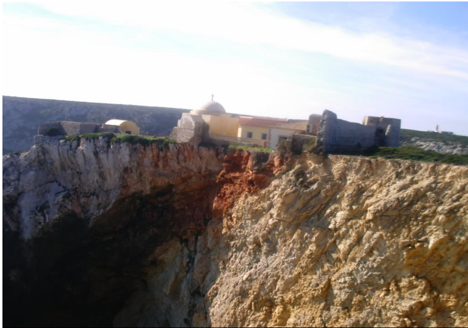
J5 – degradação da arriba que suporta a Fortaleza de Belixe
