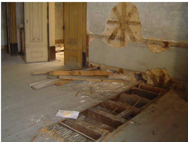
Fig. VII -12: Palácio Ribeira, fotografias obtidas na visita ao imóvel em Março de 2009. Sondagens in loco . Fotografia de autor.
