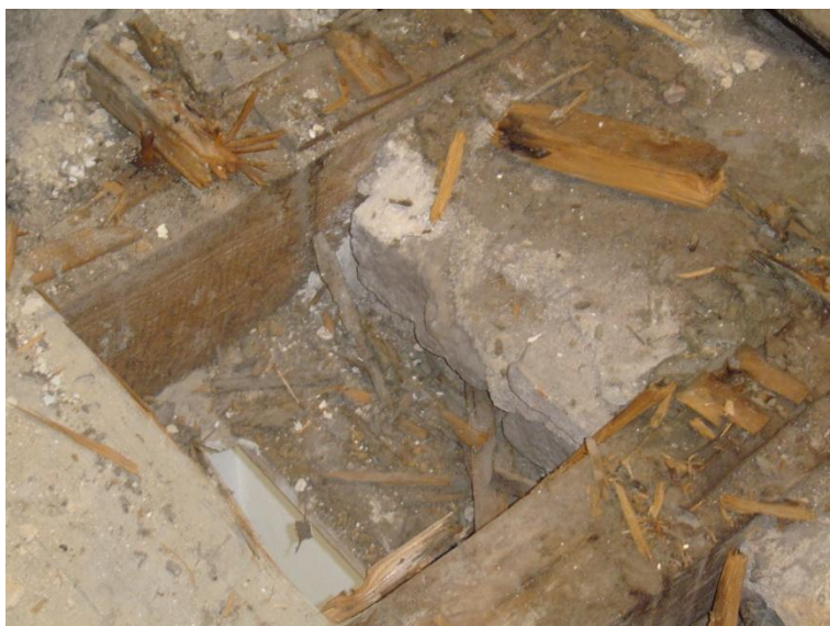
Fig. VII -9: Palácio Ribeira, fotografias obtidas na visita ao imóvel em Março de 2009. Sondagens in loco . Fotografia de autor.
