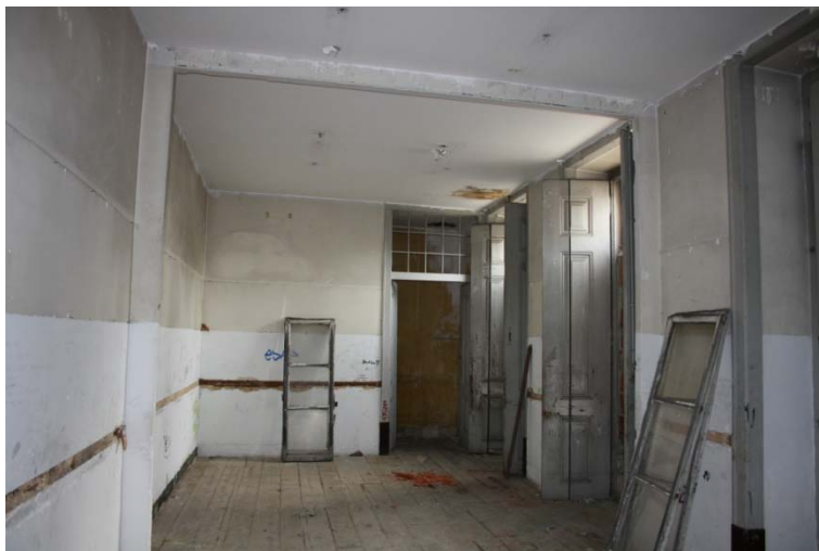
Fig. XVII -1: Palácio Ribeira, fotografias obtidas na visita ao imóvel em Março de 2010. Situação actual: Suite Mobilidade Condicionada, 1º piso (nobre). Fotografia de Maria Torres Campos.
