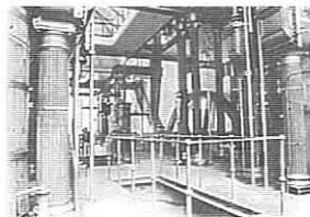
Fig. 19 A Casa das Máquinas da Estação de Barbadinhos. (Foto Postal)
