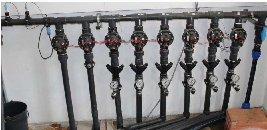
Figura 17 - Condutas de rega de cada setor.
