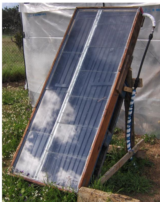
Fig. 35 - Painel solar térmico
