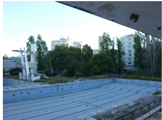
Fig. 3 - Piscinas Municipais dos Olivais em extremo estado de degradação
