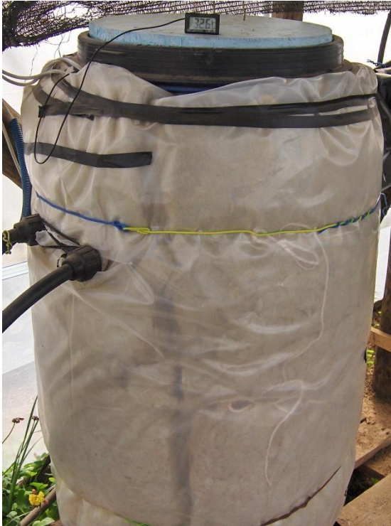
Fig. 37 - Reservatório de água quente, forrado a lâ-de-rocha
