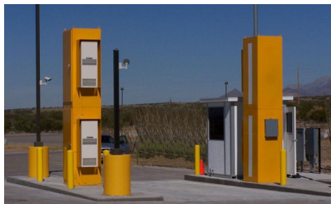
Figura 15: Pórtico secundário de HPGe instalado em Anthony, New Mexico (velocidade dos veículos limitada a 3,5 km/h) (Keyser e Twomey, 2010).
