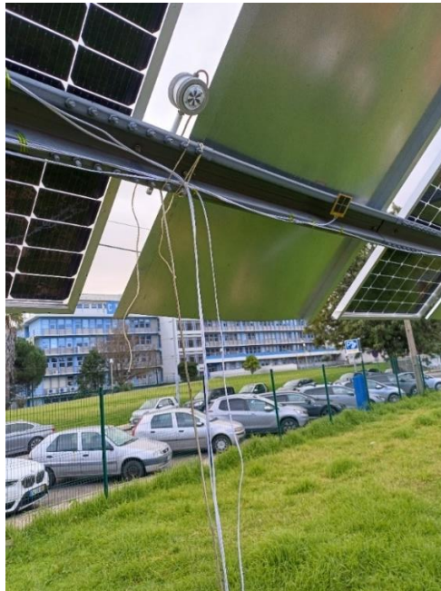
Figura 3.6 - Instalação do albedómetro e da célula PV central.
