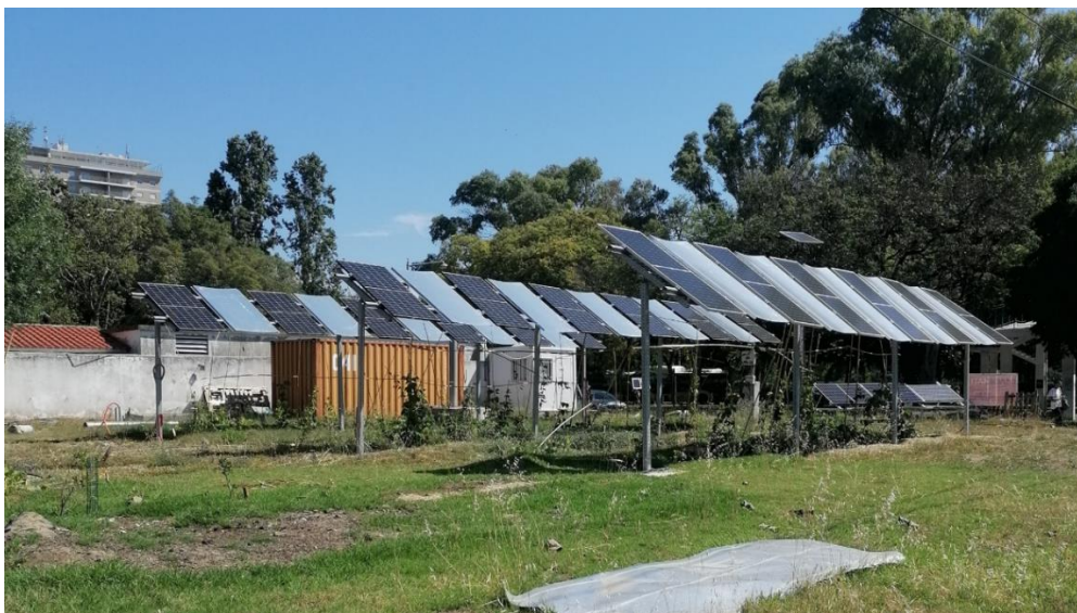
Figura 3.1 - Sistema agriPV situado no Campus Solar da FCUL (38,7575° N; -9,1562° O).
