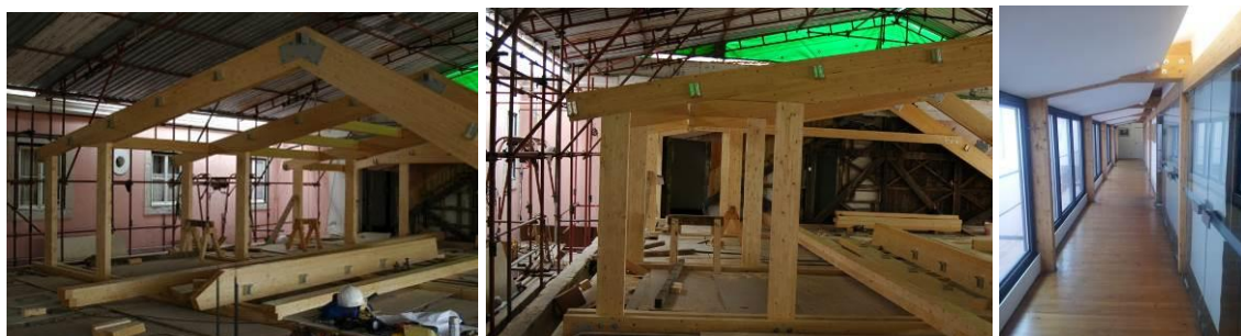
Fig.76 e 77. Estruturas em madeiras lameladas coladas com as asnas assimétricas para criação de corredor Fig. 78. Corredor com as janelas laterais em resultado da subida da perna da asna
