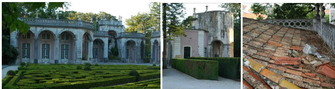
Fig.85 e 86. Viveiros de pássaros, alçados Sul e Norte com escorrências e fungos.
