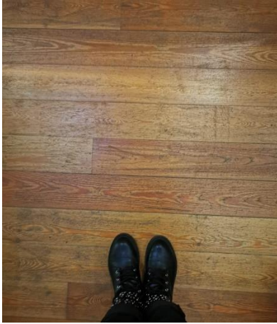
Figura 4.23. – Pavimento do Laboratório Chimico em Soalho de Pinho | Fonte: Autora
