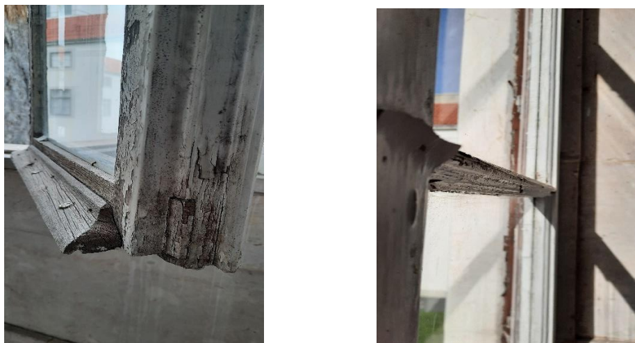
Figura 5.61.– Degradação das Caixilharias de Madeira | Fonte: Autora
