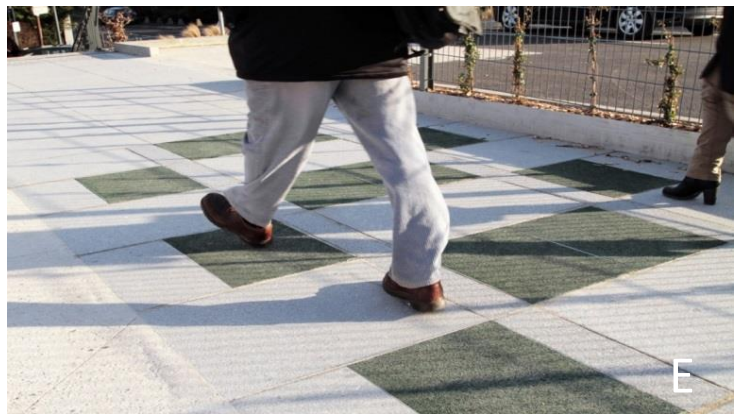
Figura 65 : Instalação do sistema Pavgen na Estação de Saint-Omer (Fonte: http://www.pavegen.com/projects/saint-omer-train-station-northern-france )
