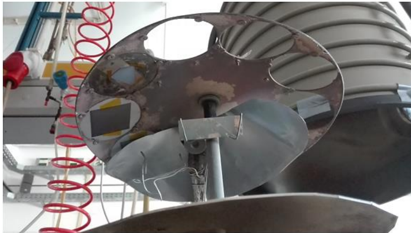
Proteção colocada no interior da câmara da evaporadora
