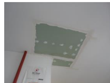
Figura 43 - Tecto da BISA danificado. Remendo de um buraco provocado pelas infiltrações
