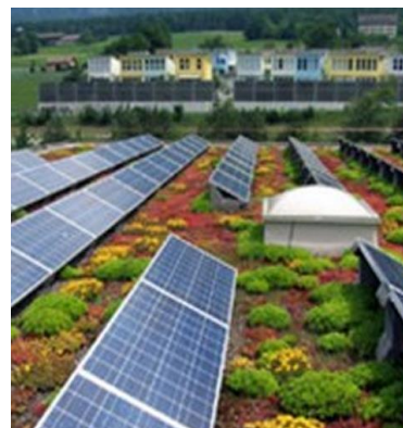
Figura 24 - Disposição dos painéis solares numa cobertura ajardinada. Fonte: < http://greentechtown.com >
