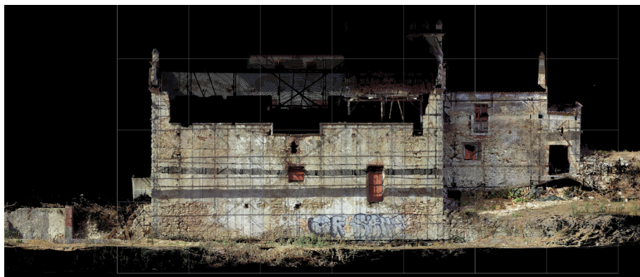
Imagem 268: Fachada Sul. Levantamento efectuado com recurso a varrimento laser da autoria de Luís Mateus.
