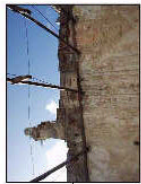
Falha da superfície do Torreão A NOROESTE
