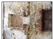
Ausência do pavimento interior
