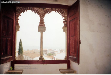
Imagem 154: Janelas geminadas com conversadeiras, existentes na torre de menagem do Paço do Alvito.
