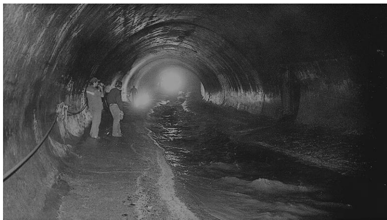
Figura 7 - Ribeira de Alcântara encanada. Visita à mesma pela presença de roturas graves. (Diário de Notícias)
