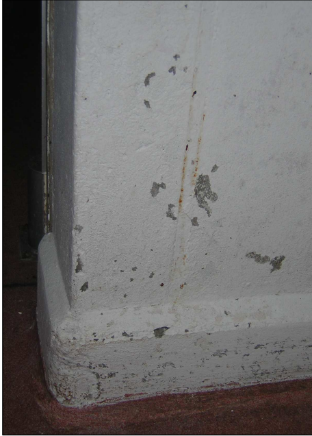
Figura 6. Exemplo de uma zona da empresa em que as paredes necessitam de uma nova pintura
