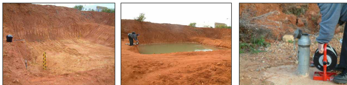
Figura 5.5 – Bacia de infiltração na 2ª camada litológica, antes e após o seu enchimento. Pormenor do piezómetro LNEC4 durante o registo manual da profundidade do nível da água
