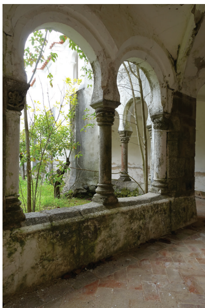
Figura 79. Líqüenes e manchas Fonte: Autor
