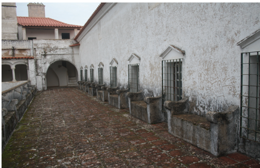
Figura 72. Degradação Exterior Fonte: Autor
