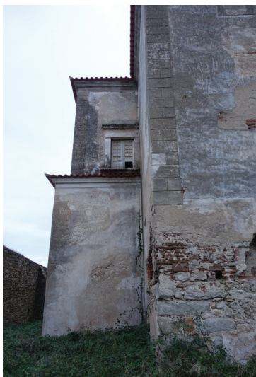
Figura 77. Perda do revestimento exterior Fonte: Autor
