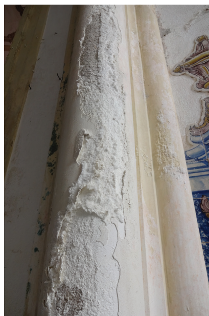
Figura 76. Eflorescências Fonte: Autor
