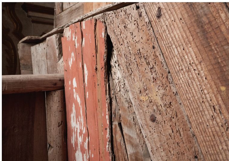
Figura 78. Humidade, térmitas e fungos Fonte: Autor
