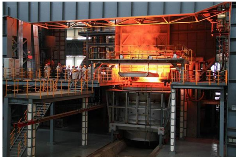
Fig.014 – Forno de arco elétrico
