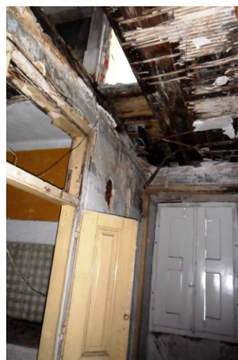
Fig. 29 - Registro Fotográfico dos interiores do imóvel estudado, anomalia 3. registo do autor.
