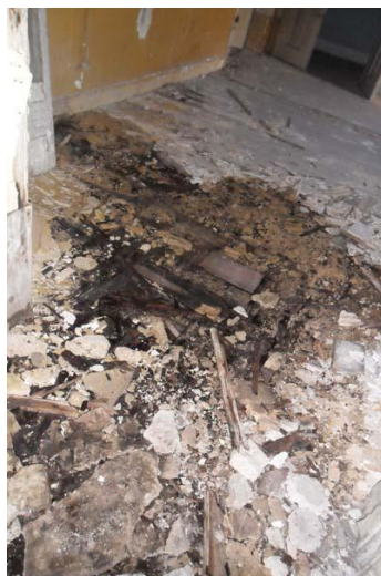
Fig. 28 - Registro Fotográfico dos interiores do imóvel estudado, anomalia 2. registo do autor.
