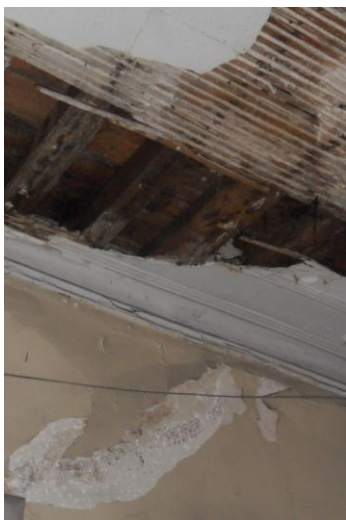
Fig. 27 - Registro Fotográfico dos interiores do imóvel estudado, anomalia 1. registo do autor.
