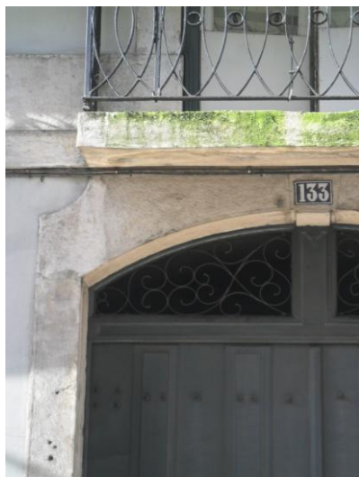
Fig. 39 - Registo Fotográfico do imóvel estudado, exemplo de bom estado de conservação da pintura da fachada, bom estado dos materiais ferrosos nas varandas e portas, registo do autor.
