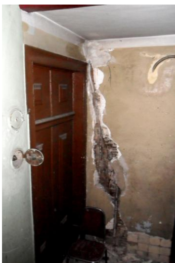
Fig. 30 - Registro Fotográfico dos interiores do imóvel estudado, anomalia 4. registo do autor.
