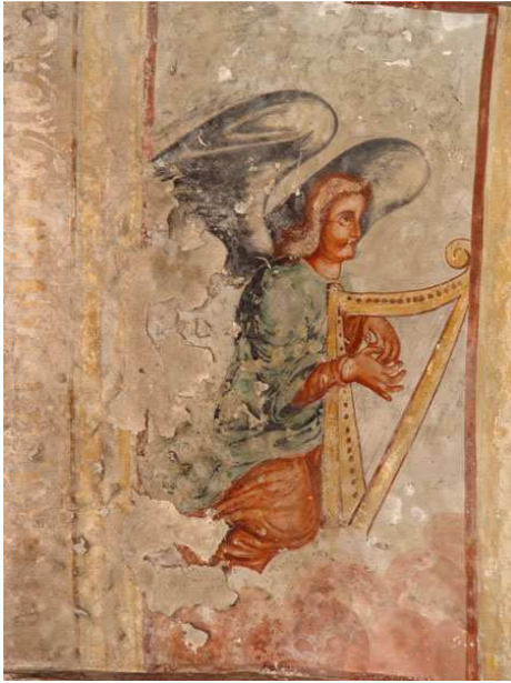
Fig. 262 – Pintura a descamar (pormenor), igreja de N.ª Sr.ª da Conceição, Monforte.
