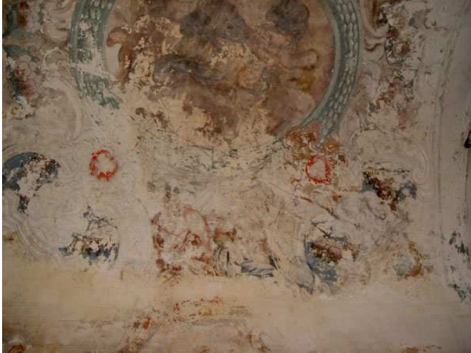
Fig. 313 – Deterioração das pinturas da abóbada da capela da Casa do Morgado (pormenor), Castelo de Vide.
