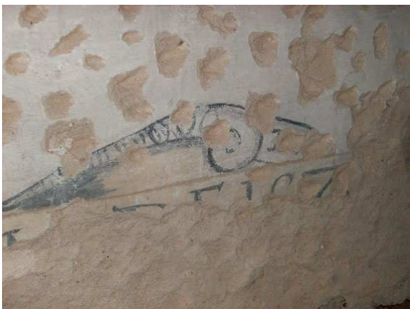
Fig. 89 – Vestígios de data sobre porta da igreja antes da intervenção de conservação e restauro (157...?).
