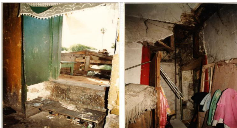
Figura 18 - Estado degradado de uma habitação da Zona Velha
