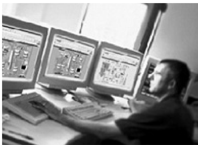
Figura 11.2. Exemplo de uma sala de controlo, com sistema de comando computadorizado [5].
