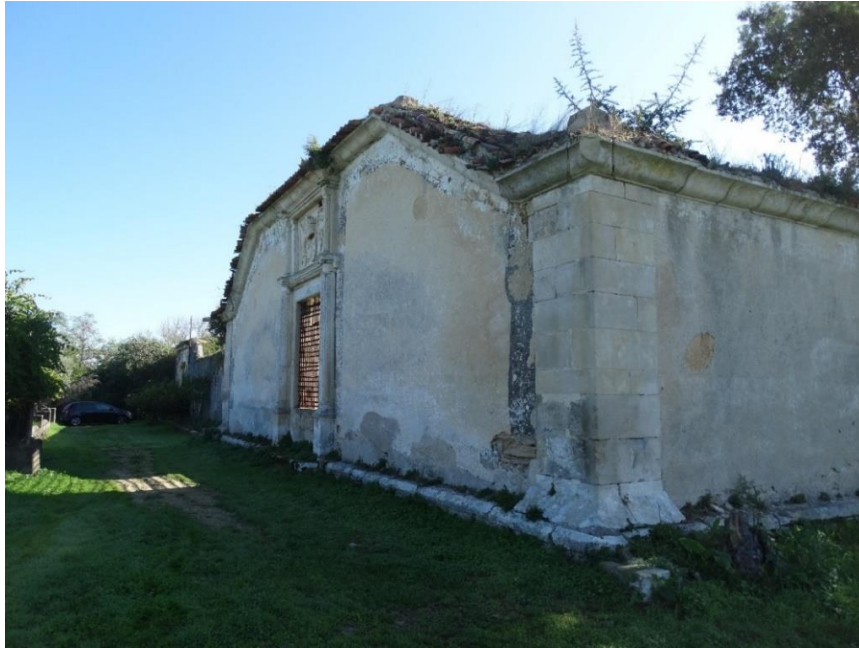
Figura 45 Alçado Poente do Celeiro, Patologias
