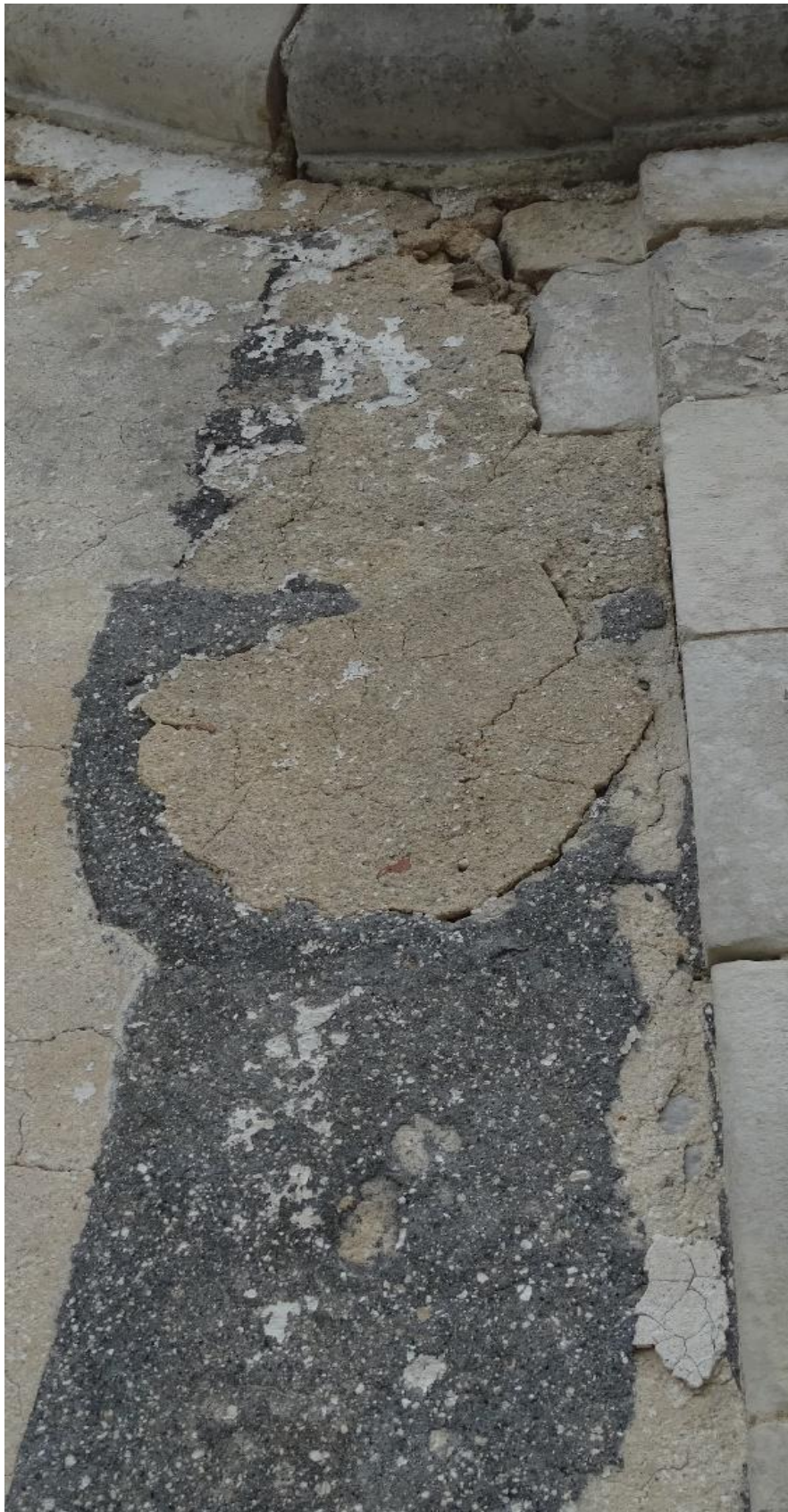
Figura 47 Alçado Poente do Paço, Patologias
