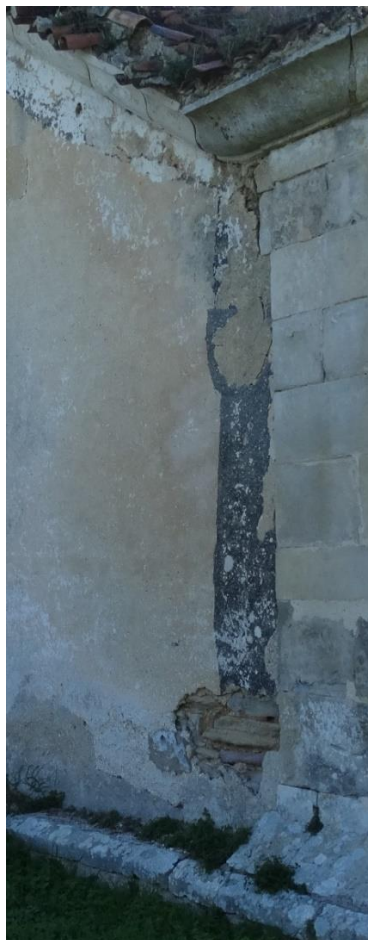
Figura 46 Alçado Poente do Paço, Patologias
