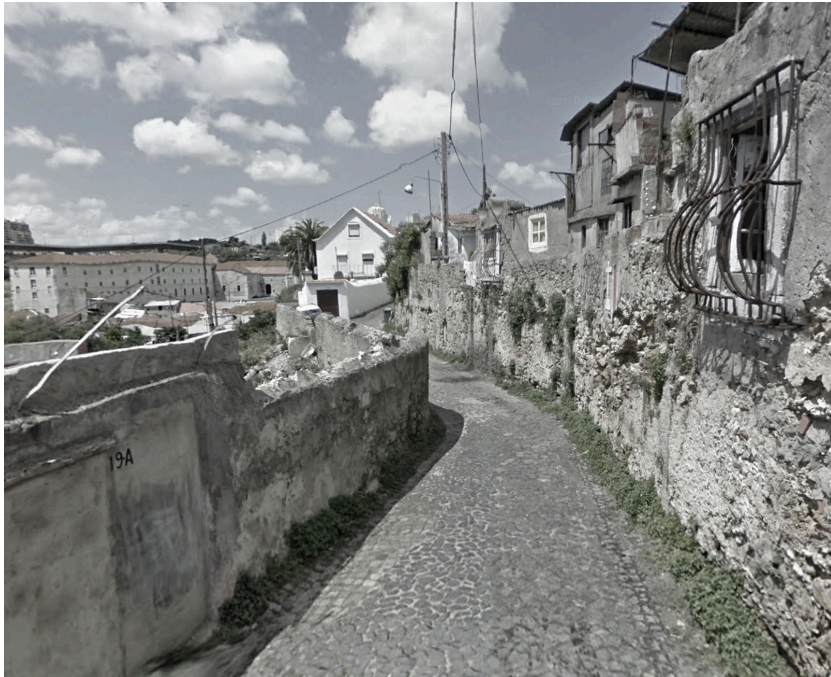
77: Azinhaga da Rua de Cima de Chelas. Edificado com necessidades de recuperação. Imagem do Google Maps , edição do autor.
