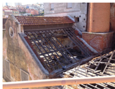
25: A primeira casa das máquinas. 2018, estado do telhado. 2018, fotografia do autor.
